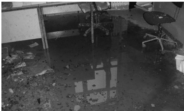
Fachschaftsraum Jura: Teile der durchgebrannten Zwischendecke und vor allem Löschwasser bedecken den Boden.
